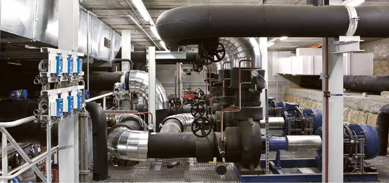
Kältepumpen Fernkältezentrale Spittelau
