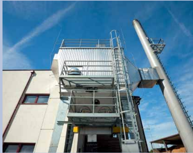
Biomasse-Heizwerk für das Ortswärmenetz Trumau
